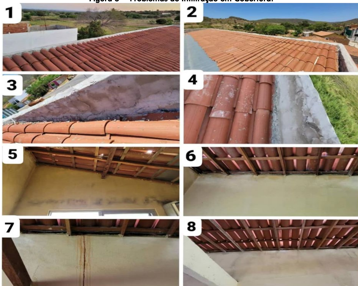
Figura 3 - Problemas de Infiltração em Cobertura.
