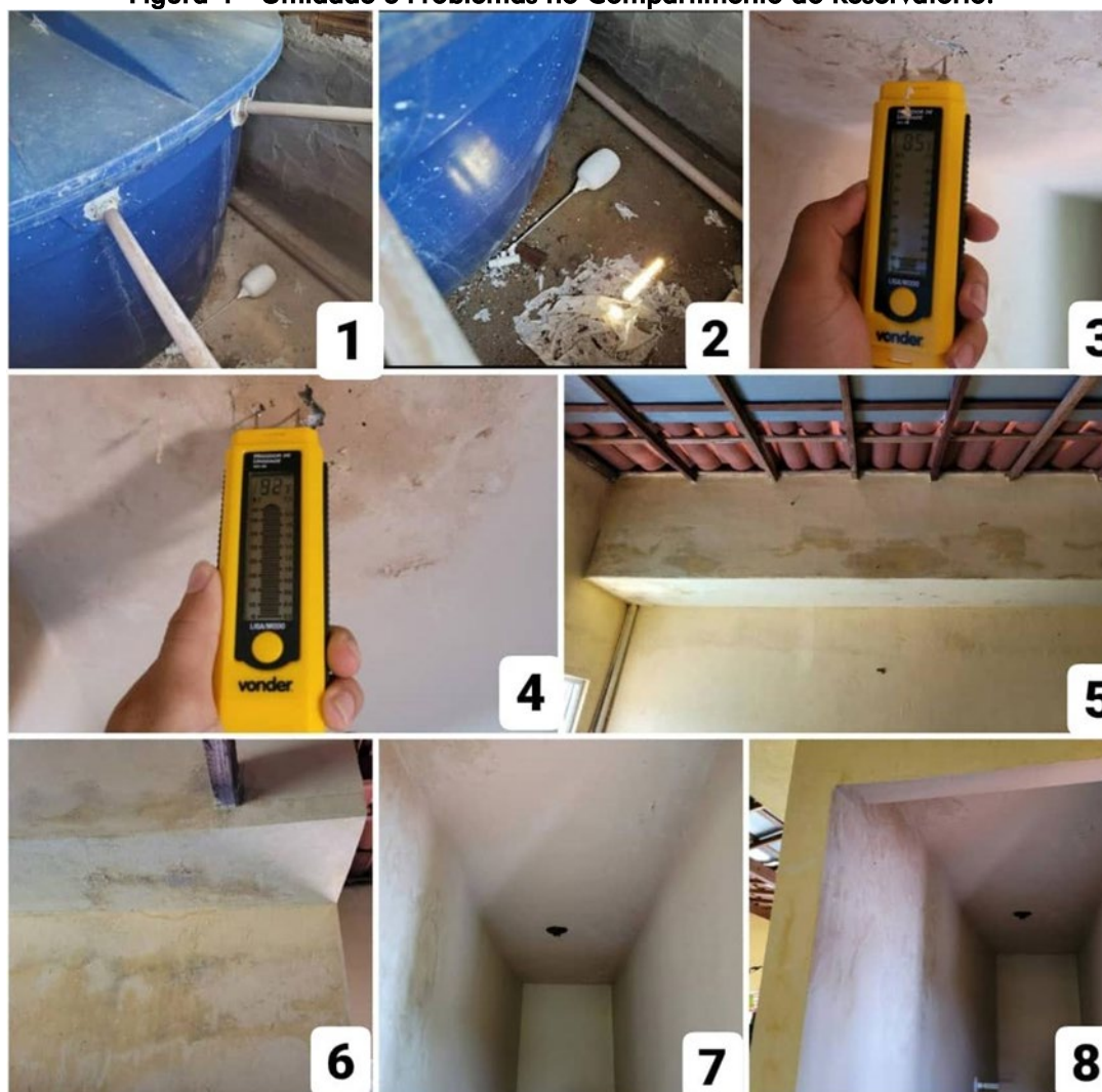
Figura 4 - Umidade e Problemas no Compartimento do Reservatório.
