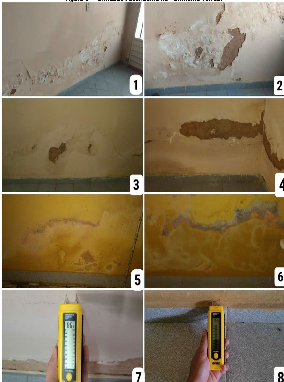
Figura 5 - Umidade Ascendente no Pavimento Térreo.
